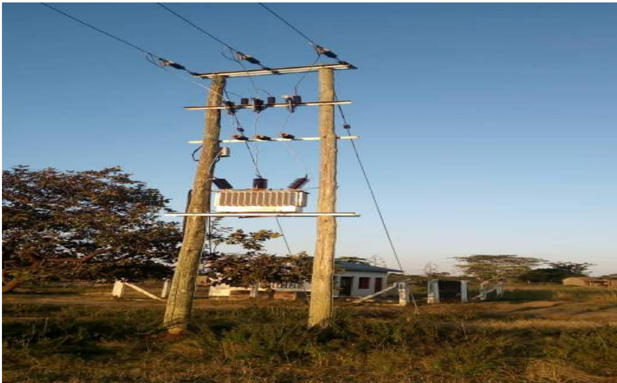
TRANSFOMA HII YA PAMPU YA MAJI NYAKAFURU
